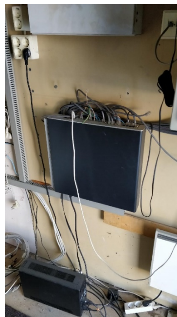
Kuva 2. Sähköpääkeskuksen puhelinjärjestelmän kytkin + UPS.
